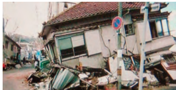
阪神大震災時の木造建物
